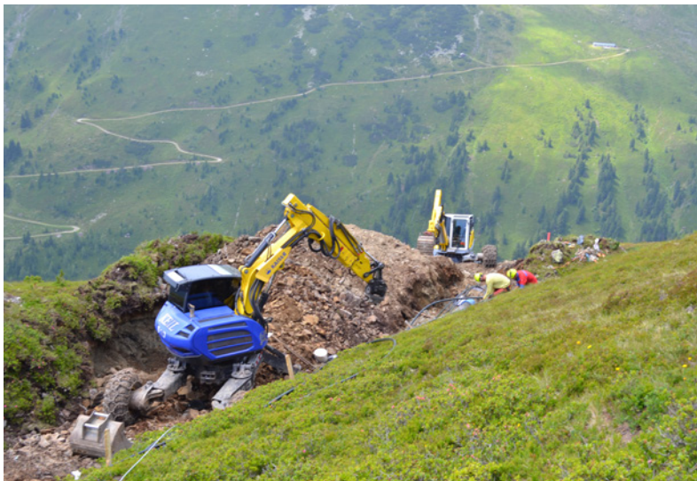
Füllleitung aus Dürnbach
